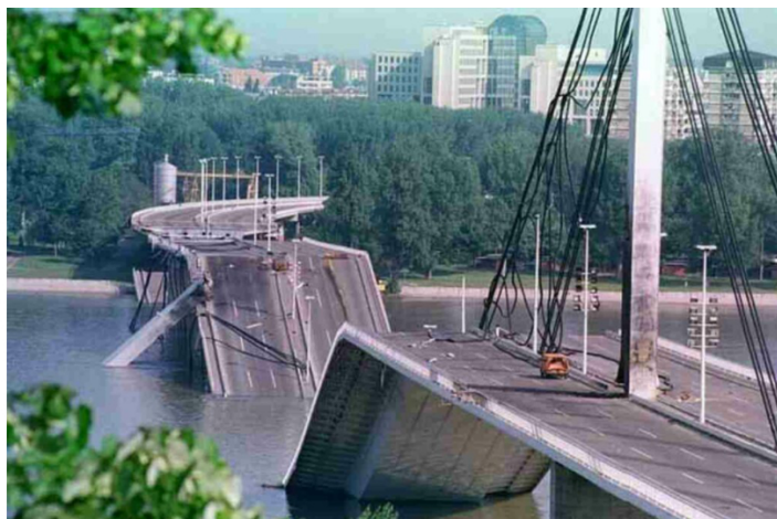
Zerstörte Freiheitsbrücke in Novi Sad. (Foto: Darko Dozet / Wikimedia Commons / CC BY-SA 3.0)
