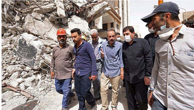
بازدید مخبر از محل ریزش ساختمان متروپل آبادان
